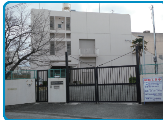
川西市 ：加茂下加茂排水区ポンプ場の老朽化対策。豪雨災害から地域を守る雨水ポンプです。 10,000万円
